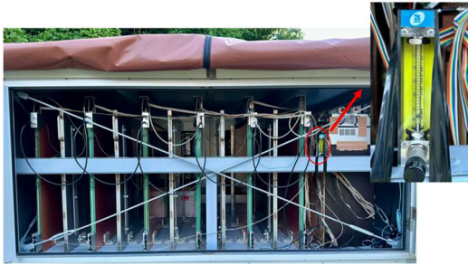
図4 流量計の設置場所
